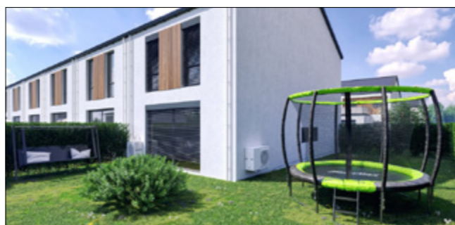
Jednostki zewnętrzne pompy ciepła powietrze/woda typu split – przykład montażu w zabudowie szeregowej
