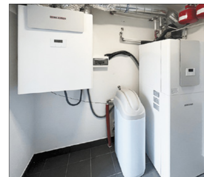
Gruntowa pompa ciepła oraz rekuperator zastosowane w zabudowie szeregowej
